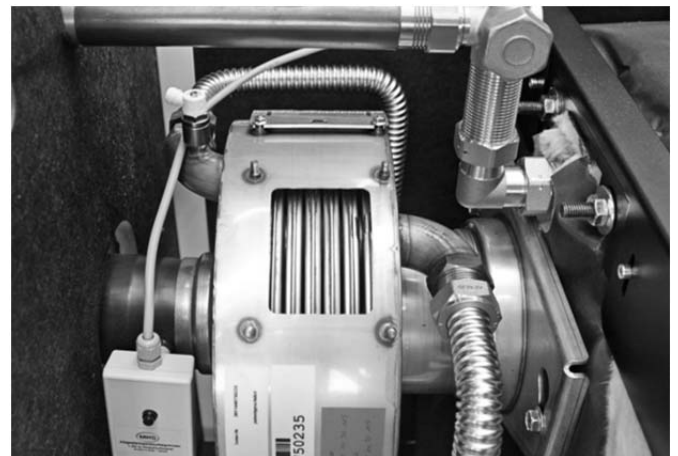
Abb. 88: Reinigungsöffnung des RWT
