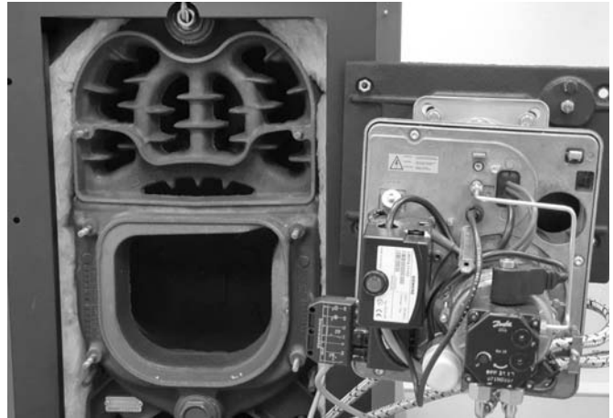
Abb. 85: Geöffneter Kessel mit Brenner in Serviceposition.
